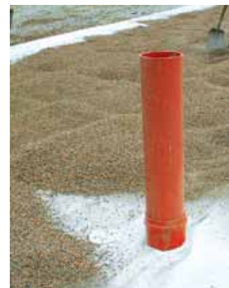
Наземная часть инспекционной трубы диаметром 200мм
