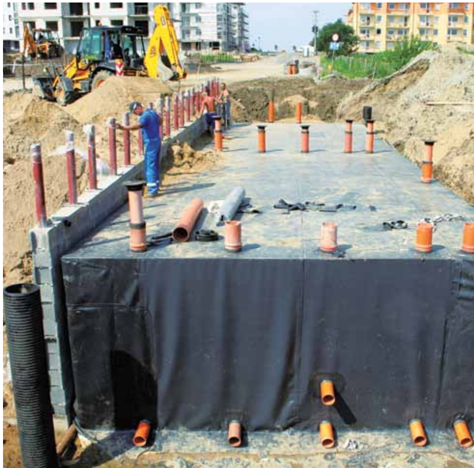
Буферный резервуар в дренажной системе
